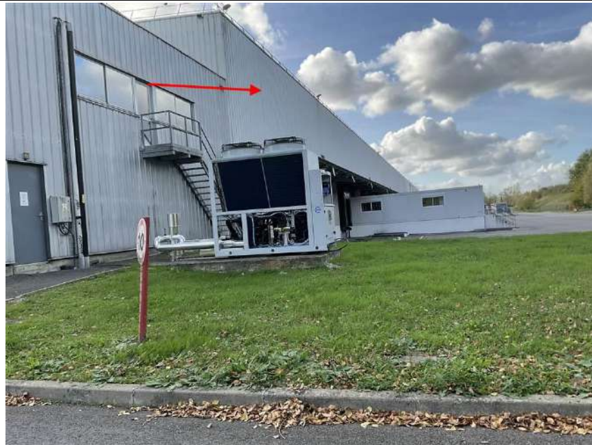
Photo n° Ph8 Localisation : EXTERIEUR Description : bardage
