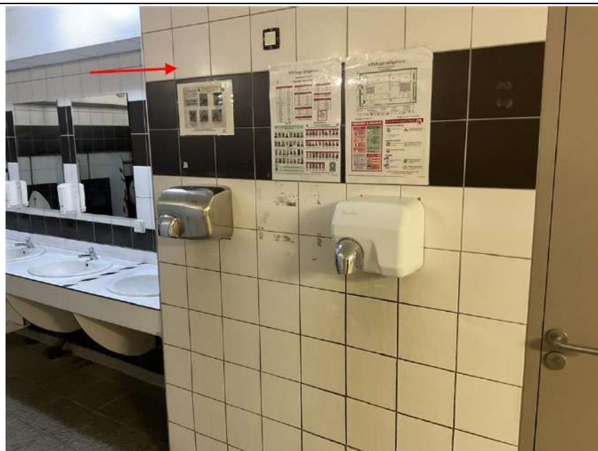
Photo n° PhDch002 Localisation : ADMINISTRATIF - VESTIAIRE HOMMES Description : Carrelage sur mur
