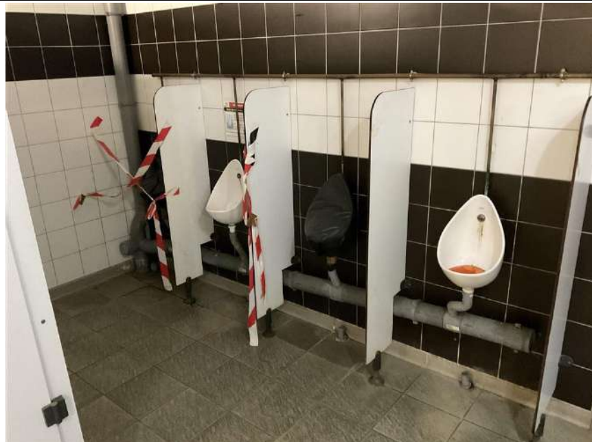
Photo n° PhDch005 Localisation : ADMINISTRATIF - VESTIAIRE HOMMES Description : toilettes
