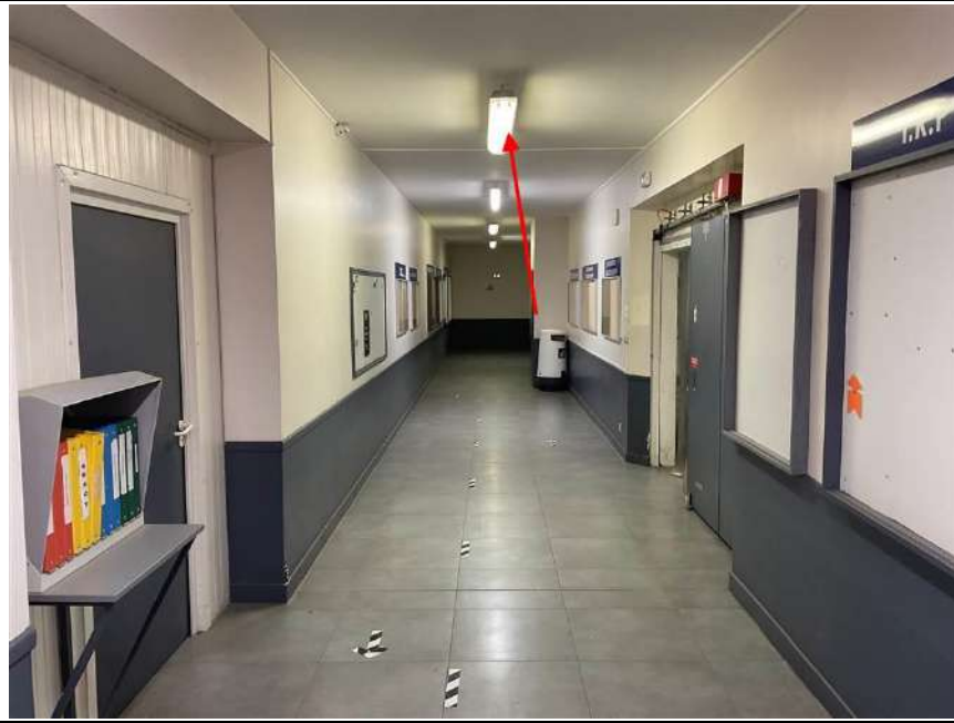
Photo n° PhDch044 Localisation : COULOIR SALLE DE CHARGE - RDC Description : Néons industrie (120 cm)
