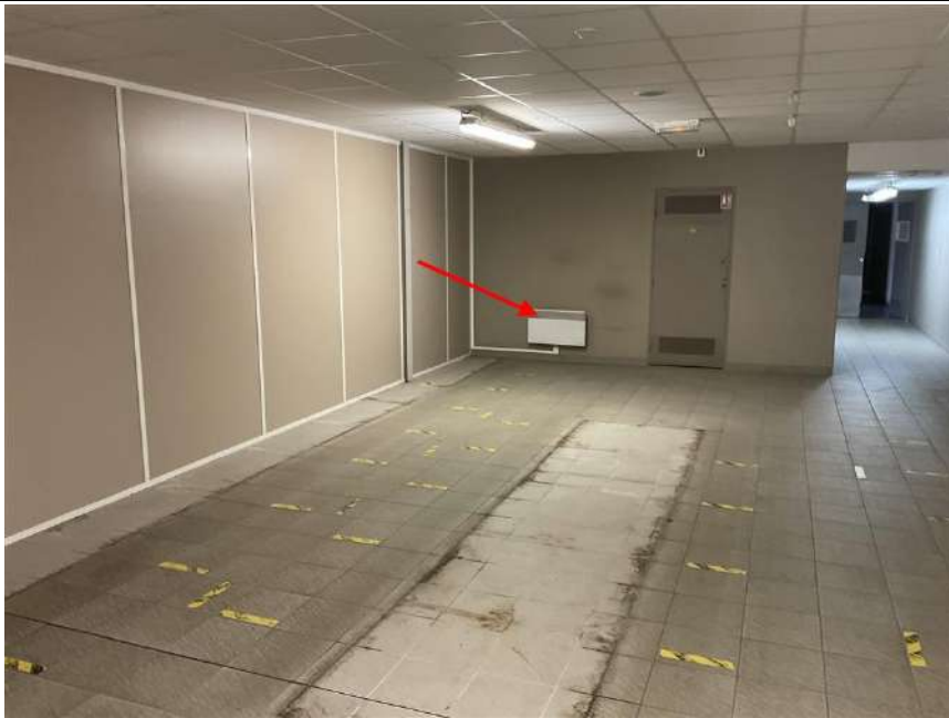
Photo n° PhDch019 Localisation : ADMINISTRATIF - VESTIAIRE HOMMES Description : Emetteurs ( 70X10X4)
