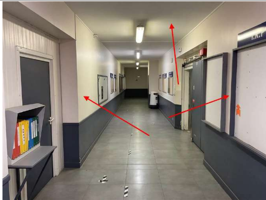
Photo n° PhDch043 Localisation : SALLE DE CHARGE/ATELIER Description : placo mur et plafond
