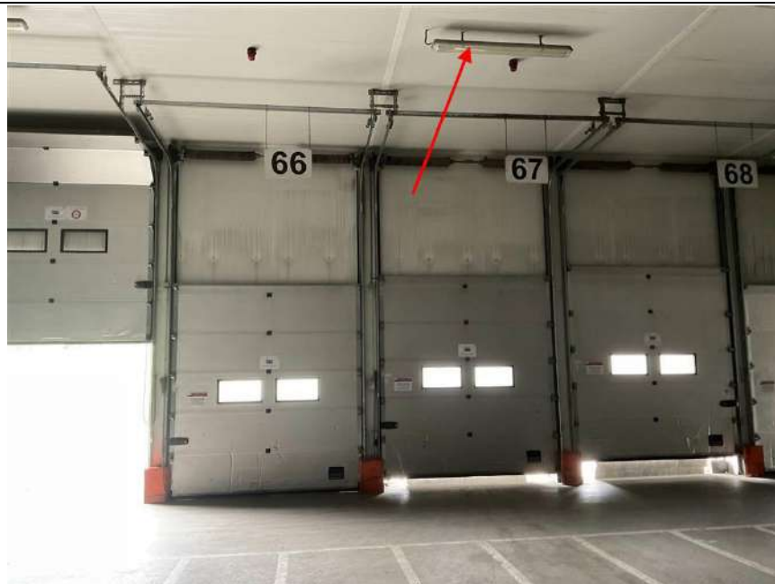
Photo n° PhDch047 Localisation : COULOIR SALLE DE CHARGE - RDC Description : Néons industrie (120 cm)
