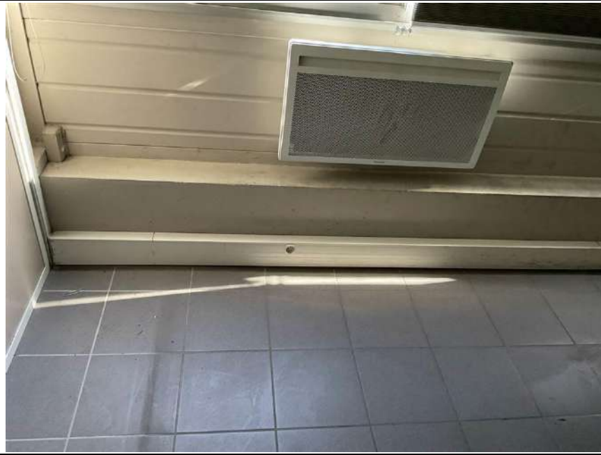
Photo n° PhDch062 Localisation : ADMINISTRATIF - VESTIAIRE HOMMES Description : radaiteur electrique 82X50X10
