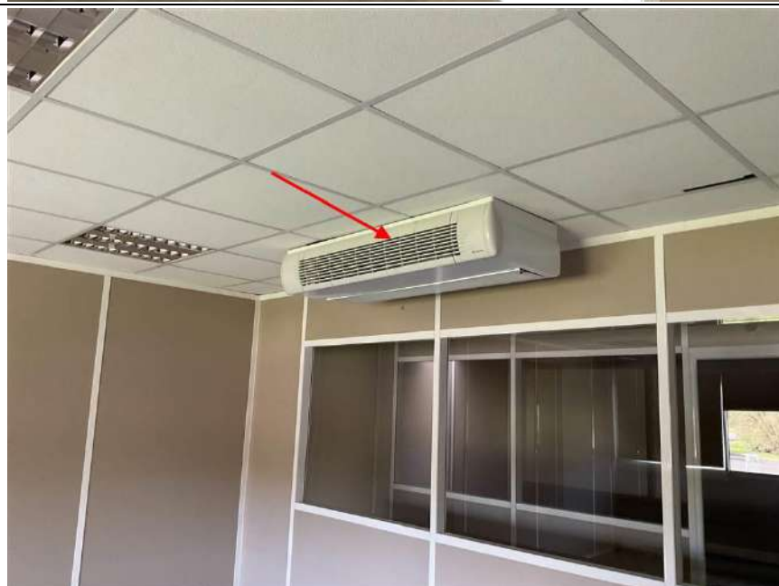
Photo n° PhDch061 Localisation : ADMINISTRATIF - VESTIAIRE HOMMES Description : climatiseur avec fluide
