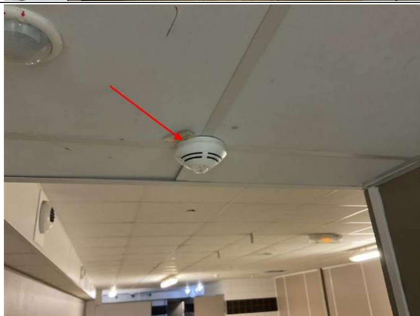
Photo n° PhDch059 Localisation : ADMINISTRATIF - VESTIAIRE HOMMES Description : détecteur de fumée
