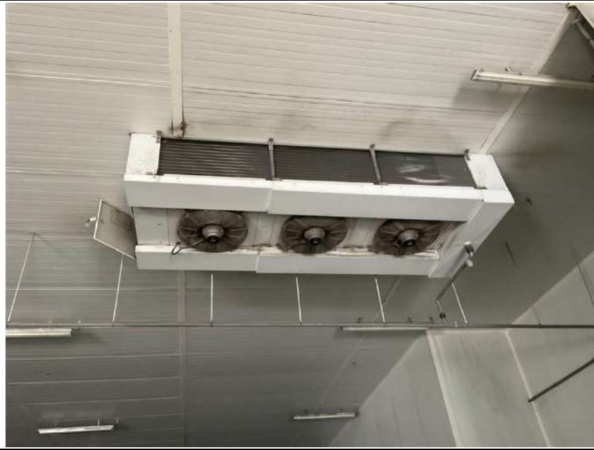
Photo n° PhDch050 Localisation : ENTREPOT FRAIS Description : evaporateur
