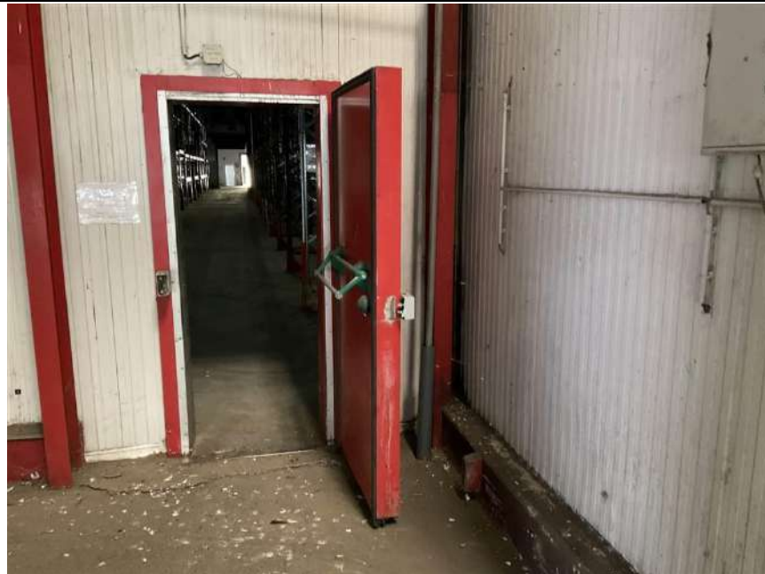
Photo n° Ph6 Localisation : COULOIR SALLE DE CHARGE - R+1 Description : porte industrielle acier
