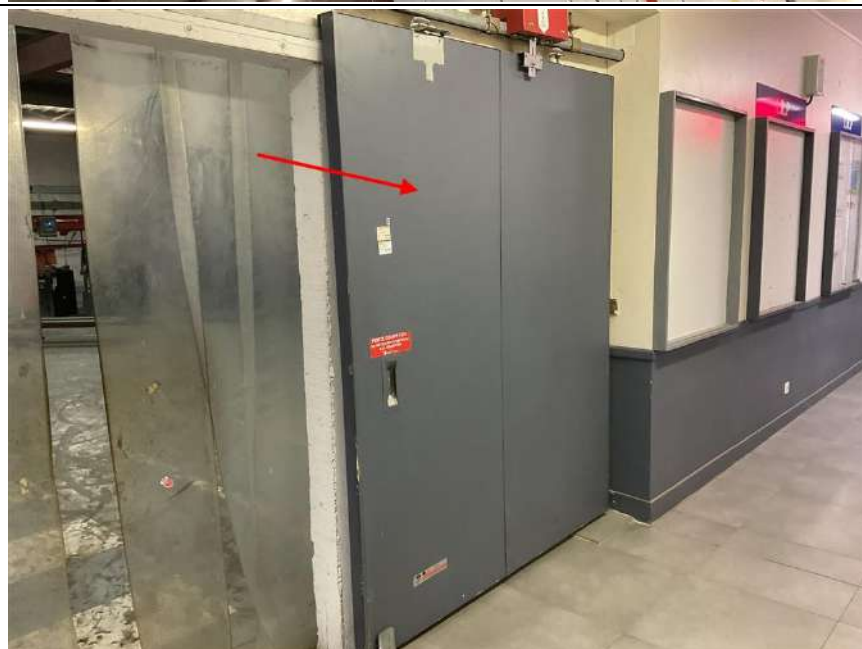
Photo n° PhDch033 Localisation : SALLE DE CHARGE/ATELIER Description : Portes coupe feu (218X1,80)
