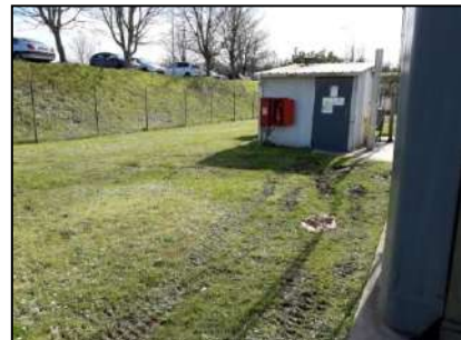
Cuves de carburant
