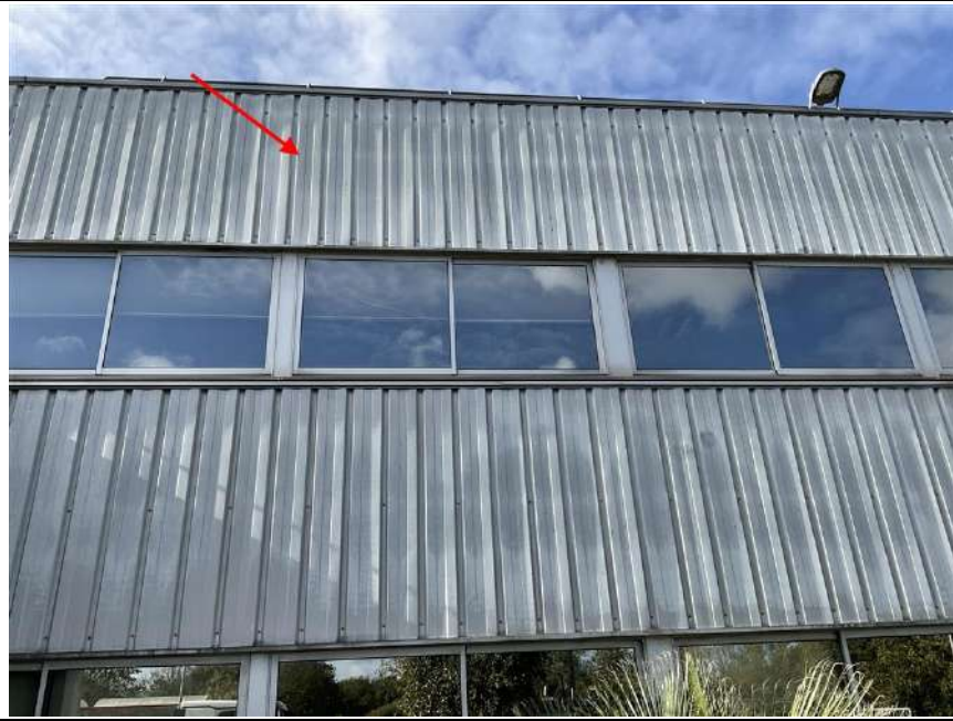
Photo n° PhDch014 Localisation : ADMINISTRATIF - BUREAUX RDC, ADMINISTRATIF - BUREAUX 1 ER Description : bardage double peau
