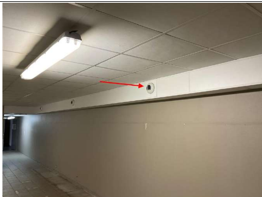
Photo n° PhDch008 Localisation : ADMINISTRATIF - VESTIAIRE HOMMES Description : bouches d'extraction
