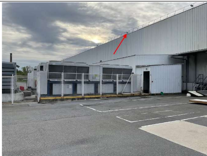
Photo n° PhDch074 Localisation : TOITURE TERRASSE Description : projecteurs sur toitures terrasse
