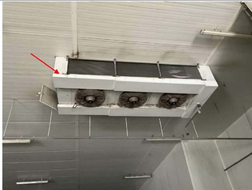
Photo n° PhDch049 Localisation : ENTREPOT FRAIS Description : contenant métal évaporateur
