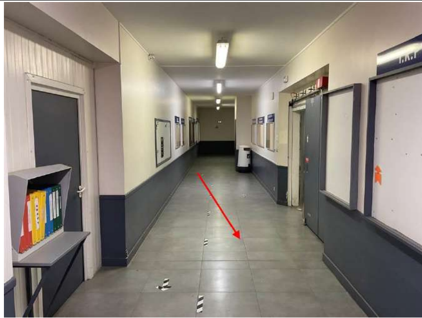
Photo n° PhDch042 Localisation : SALLE DE CHARGE/ATELIER Description : Carrelage
