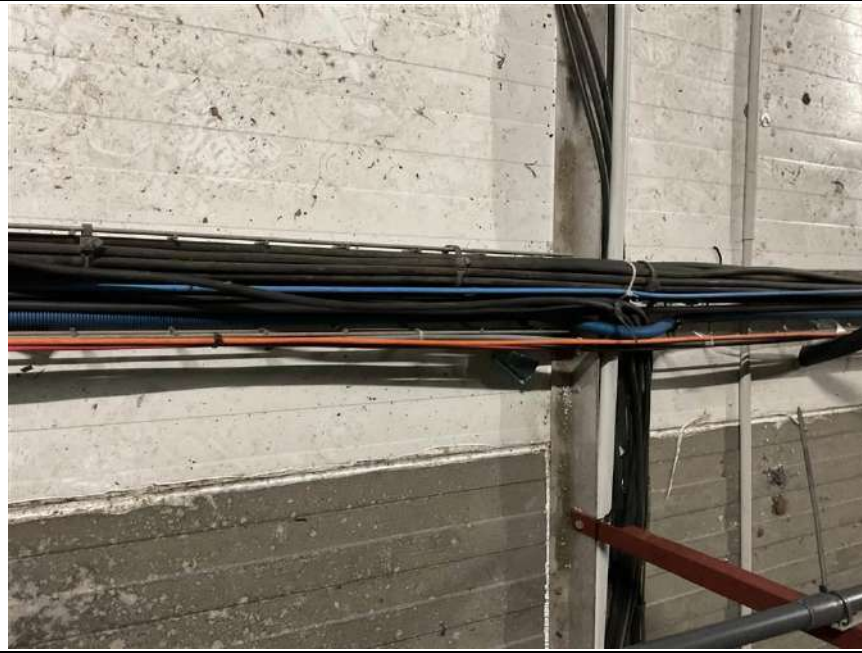
Photo n° PhDch131 Localisation : COMBLES Description : cables electriques cuivre (1,5)
