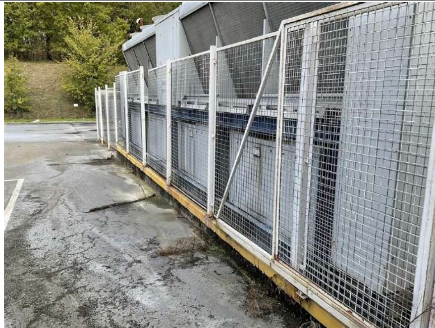
Photo n° PhDch124 Localisation : ADMINISTRATIF - BUREAUX RDC Description : GROUPE FROID
