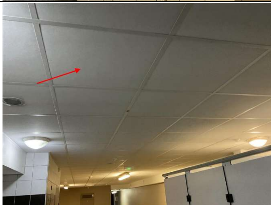
Photo n° PhDch003 Localisation : ADMINISTRATIF - VESTIAIRE HOMMES Description : dalles de faux plafond
