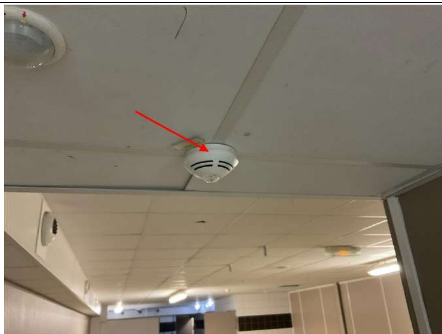
Photo n° PhDch020 Localisation : ADMINISTRATIF - VESTIAIRE HOMMES Description : détecteur de fumée
