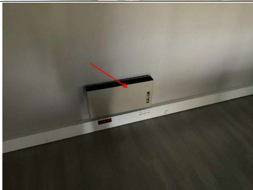
Photo n° PhDch073 Localisation : ADMINISTRATIF - BUREAUX 1 ER Description : Emetteurs ( 70X10X4)
