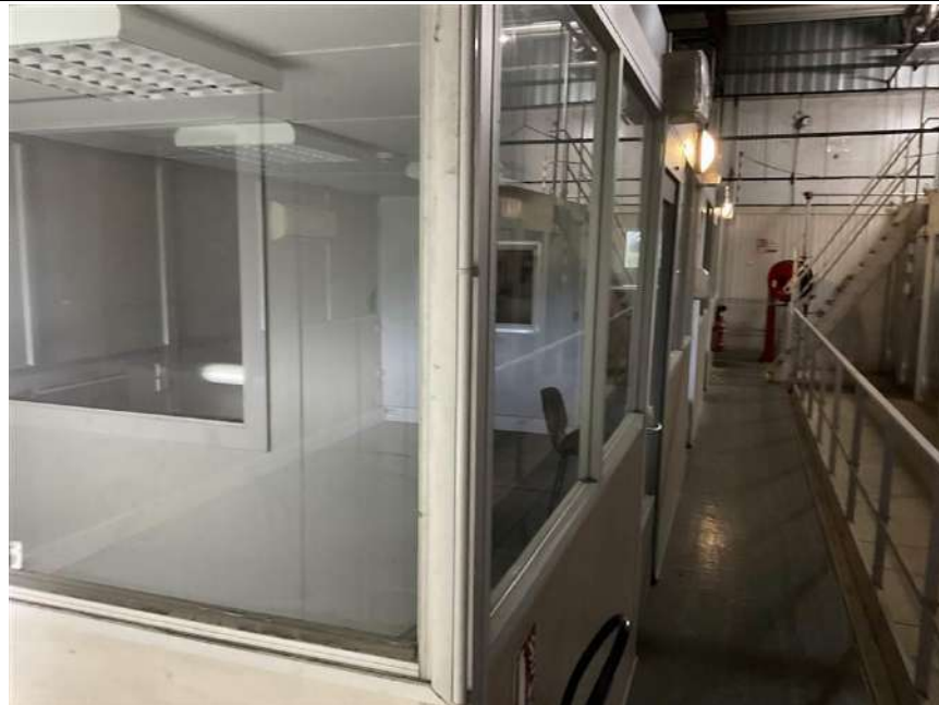
Photo n° PhDch090 Localisation : ENTREPOT FRAIS Description : panneaux sandwichs isothermes 6 cm container
