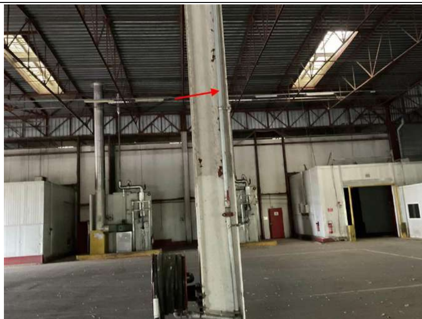
Photo n° PhDch085 Localisation : ENTREPOT GEL Description : Réseau RIA
