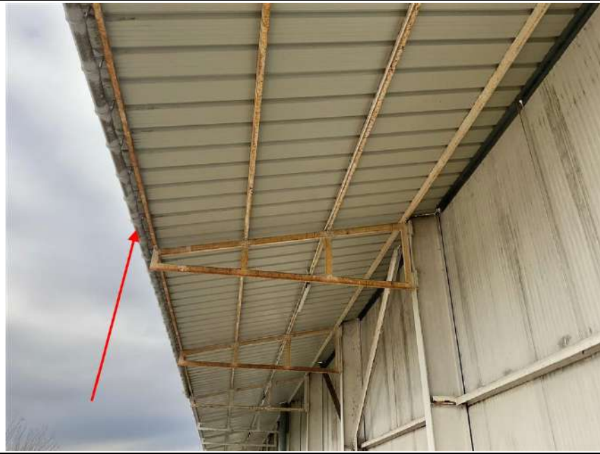
Photo n° PhDch036 Localisation : EXTERIEUR Description : Goulottes PVC ( 130X55 mm)
