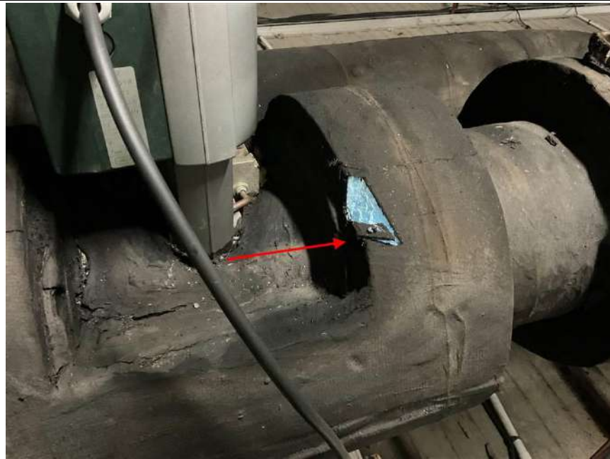
Photo n° PhDch096 Localisation : ENTREPOT FRAIS Description : conduit acier calorifugé
