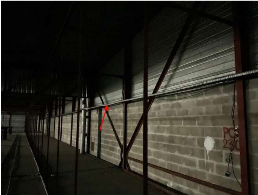
Photo n° PhDch053 Localisation : COMBLES Description : chemin de cables 200 mm
