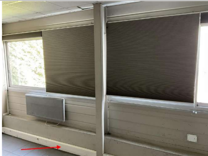
Photo n° PhDch017 Localisation : ADMINISTRATIF - BUREAUX RDC, ADMINISTRATIF - BUREAUX 1 ER Description : Goulottes PVC ( 130X55 mm)
