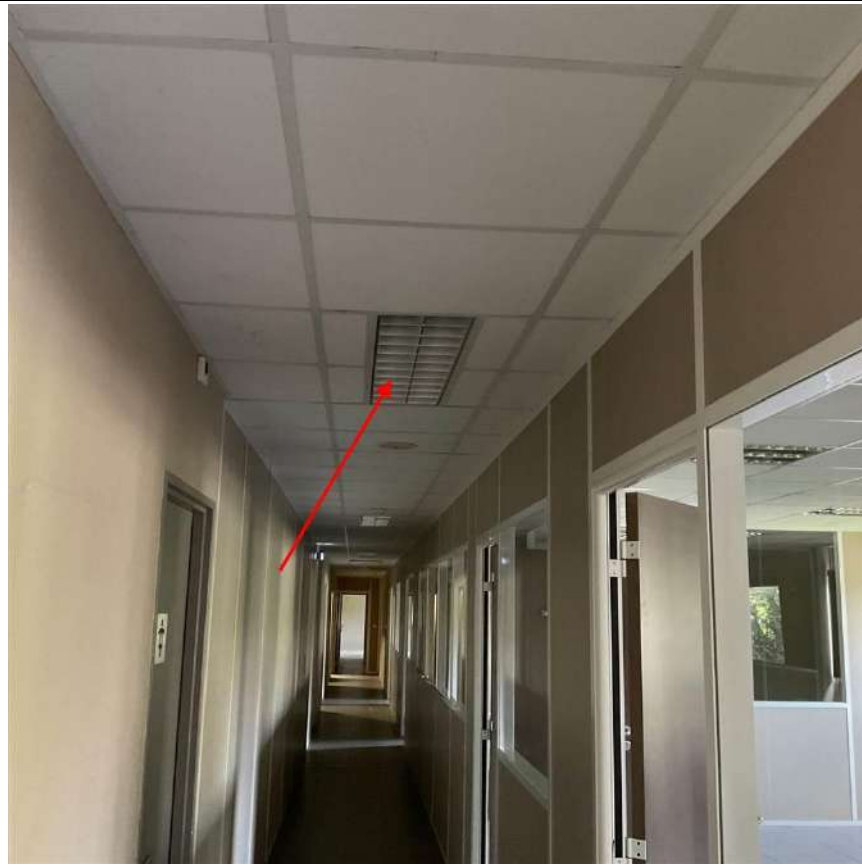
Photo n° PhDch066 Localisation : ADMINISTRATIF - BUREAUX 1 ER Description : Néons industrie (120 cm)
