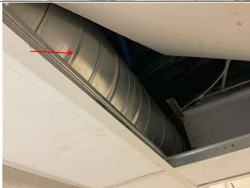
Photo n° PhDch021 Localisation : ADMINISTRATIF - VESTIAIRE HOMMES Description : conduit galva (200)
