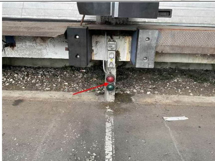
Photo n° PhDch107 Localisation : ENTREPOT FRAIS Description : Feu de signalisation extérieur
