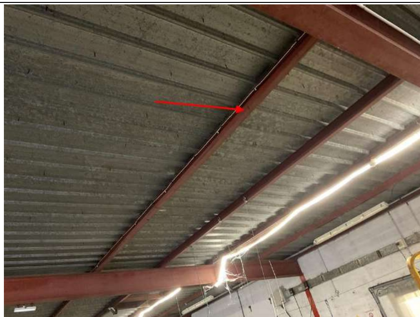
Photo n° PhDch032 Localisation : SALLE DE CHARGE/ATELIER Description : Panne métal
