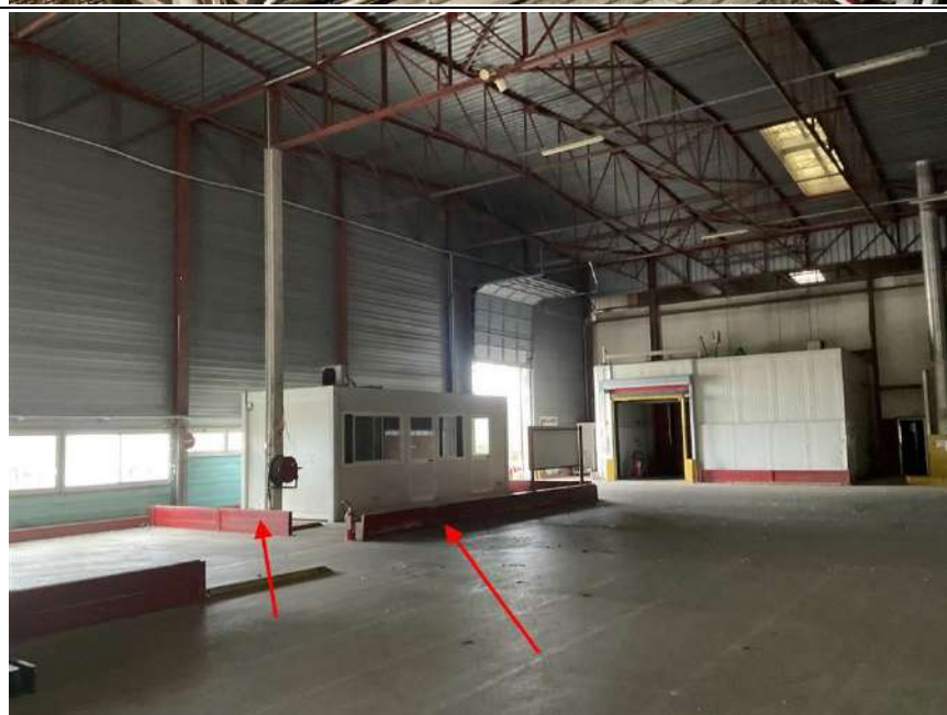
Photo n° PhDch041 Localisation : EXTERIEUR Description : plinthe stop chariot
